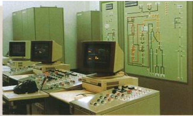
監視盤 Supervisory panel
